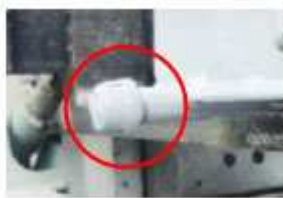
ภาพประกอบ 6 การรั่วซึมรอบนอกของหม้อแปลงไฟฟ้า
